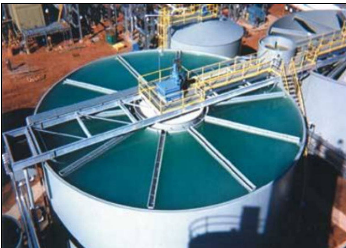
Figura 9 – Decantador de manto de lodo “floco-decantador”.
