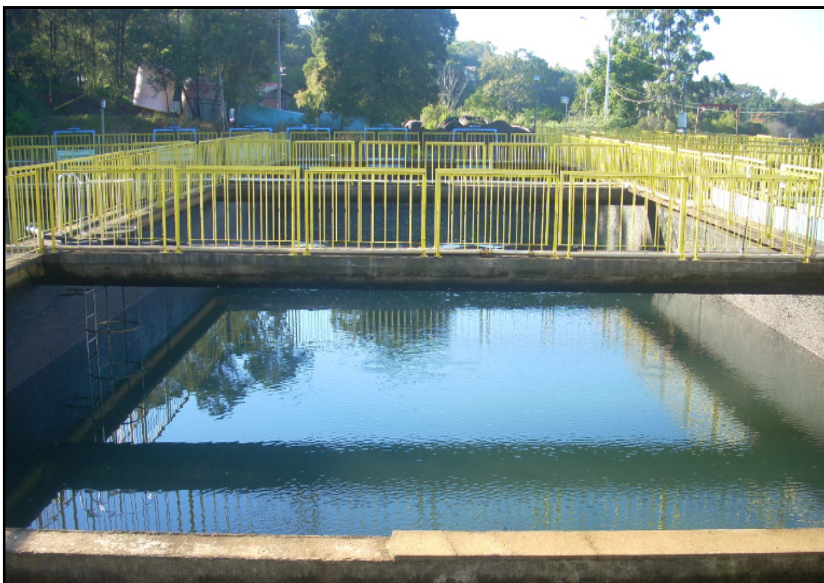
Figura 10 – Decantador de escoamento horizontal na ETA da COMUSA, NH, RS, 2009. Fonte – Elaborado pelo autor.
