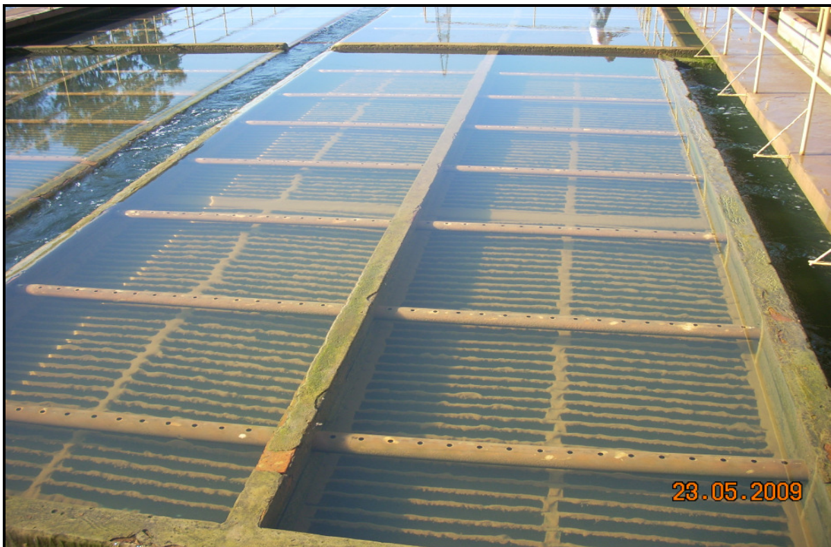
Figura 12 – Decantador de alta taxa na ETA da CORSAN, Esteio, RS, 2009. Fonte – Elaborado pelo autor.
