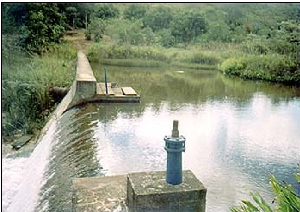
Figura 4 – Barragem de nível na sub-bacia do Bom Retiro para captação de água. Fonte – SAAE Oliveira-MG, 2009.
