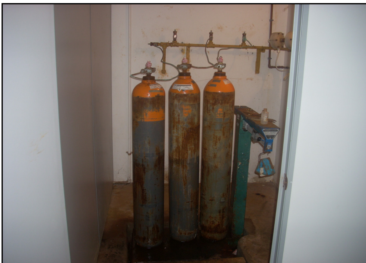
Figura 16 – Sistema de desinfecção Cloro gás na ETA da CORSAN, Taquara, RS, 2009. Fonte – Elaborado pelo autor.
