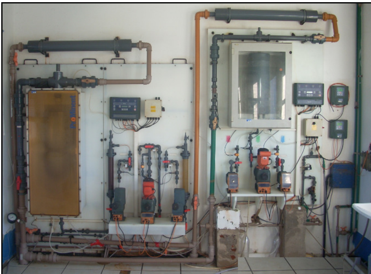
Figura 17 – Gerador de dióxido de cloro na ETA da COMUSA, N.H., RS, 2009. Fonte – Elaborado pelo autor.
