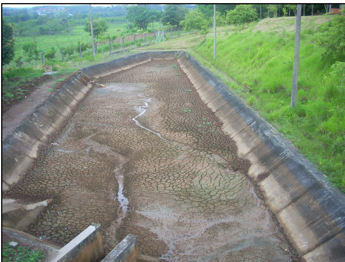
Figura 13 – Leito de Secagem na ETA da CORSAN, Parobé, RS, 2009. Fonte – Elaborado pelo autor.
