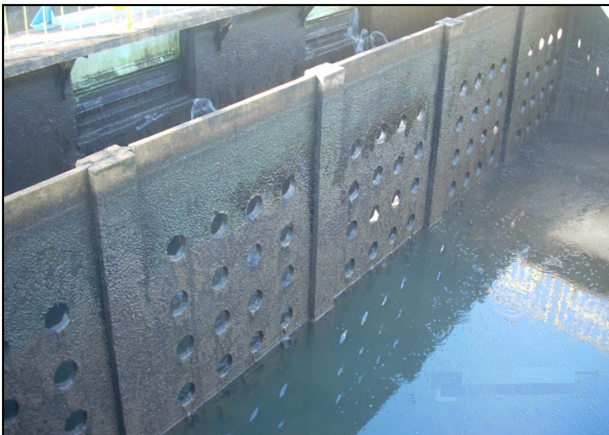
Figura 11 – Cortina difusora do Decantador na ETA da COMUSA, NH, RS, 2009. Fonte – Elaborado pelo autor.
