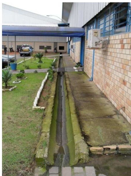
Figura 21 - Canaletas de escoamento. Fonte: Dados fornecidos pela empresa.
