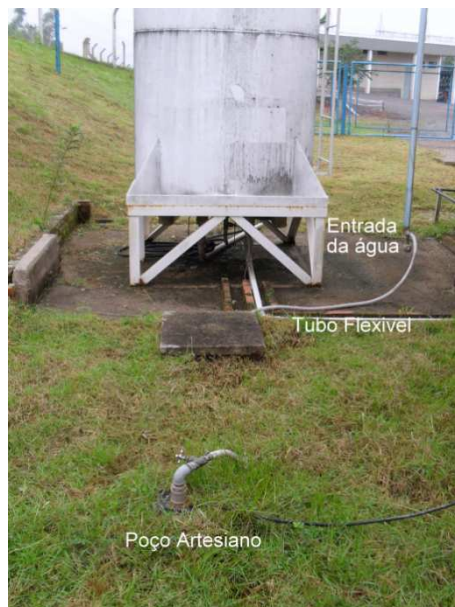
Figura 10 – Localização do poço artesiano. Fonte: Dados fornecidos pela empresa.
