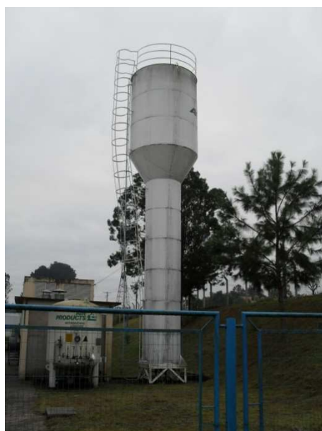
Figura 9 – Reservatório de água potável. Fonte: Dados fornecidos pela empresa.
