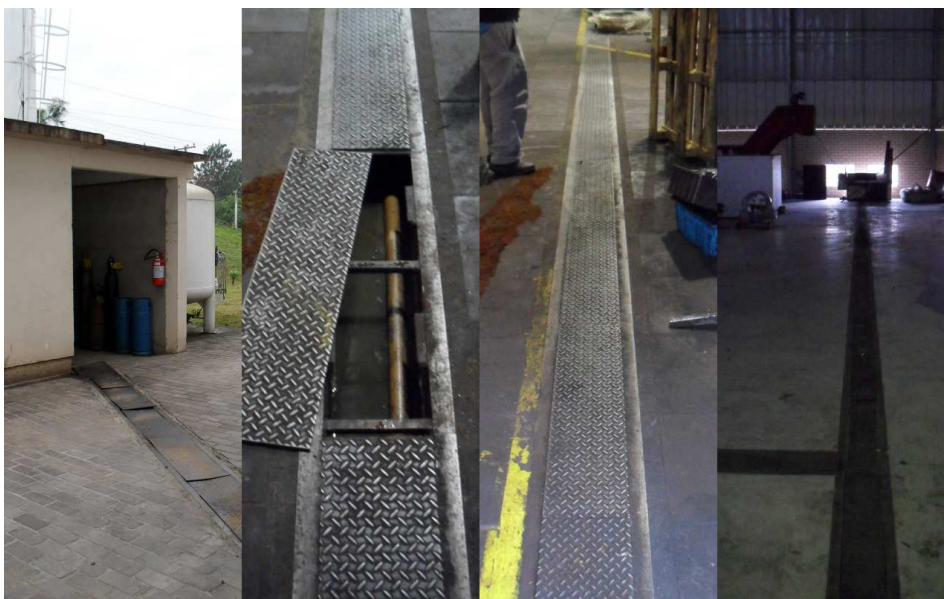
Figura 12 - Canaletas de distribuição. Fonte: Dados fornecidos pela empresa.
