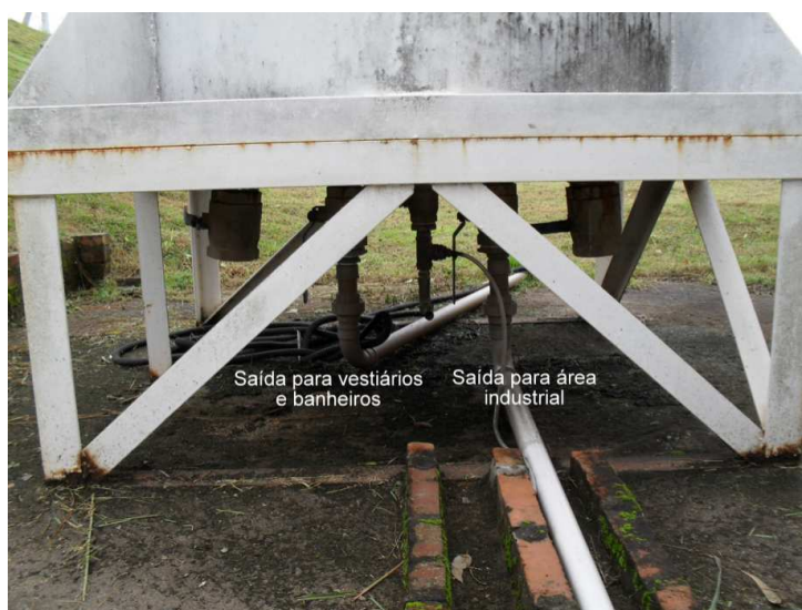
Figura 11 - Localização das saídas de água Fonte: Dados fornecidos pela empresa
