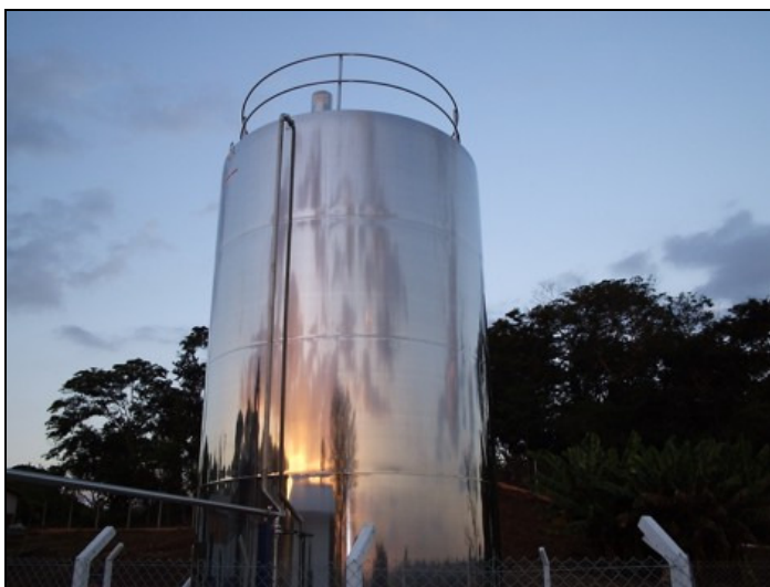
Figura 9 - Reservatório em aço inox.
