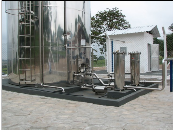
Figura 10 - Sistema de bombas e filtros.
