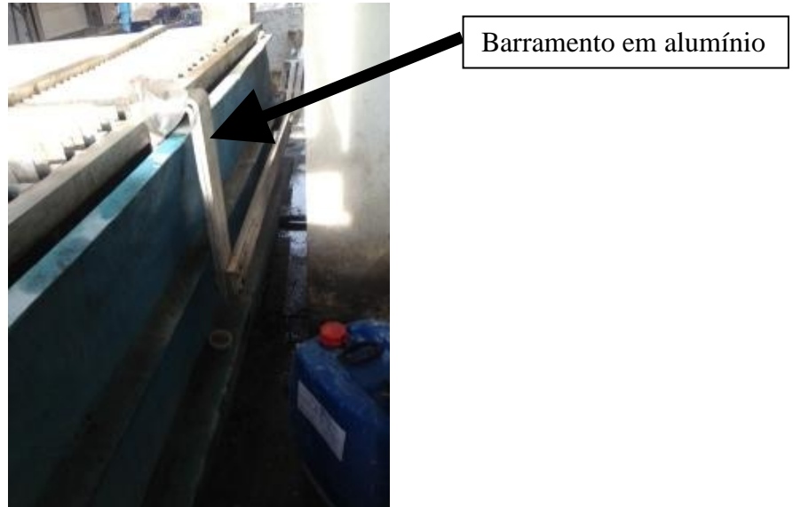
Figura 16 – Barramento de alumínio para a condução de energia elétrica aos eletrodos.
