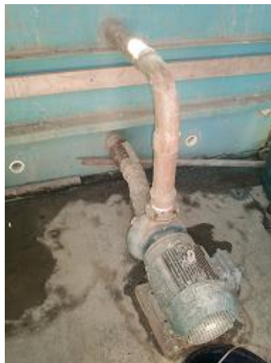
Figura 17 – Motobomba JC-10 de 10CV, que possibilita a agitação por meio da recirculação de efluente no tanque de eletrocoagulação.
