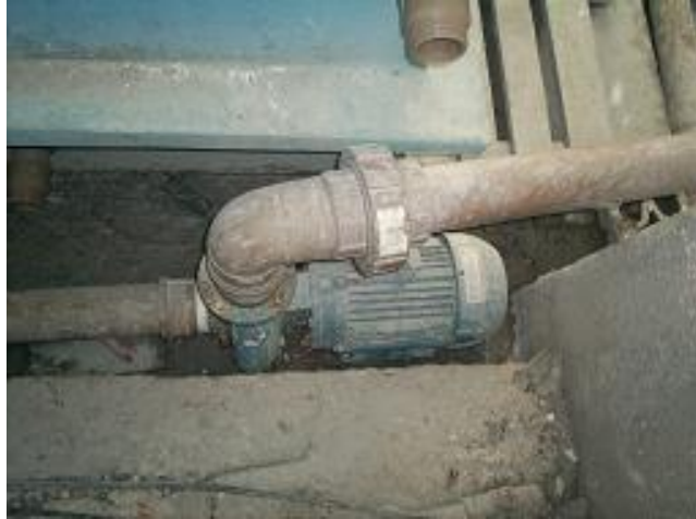
Figura 19 – Motobomba JC-5 de 5CV de recalque do efluente do reator eletroquímico ao decantador
