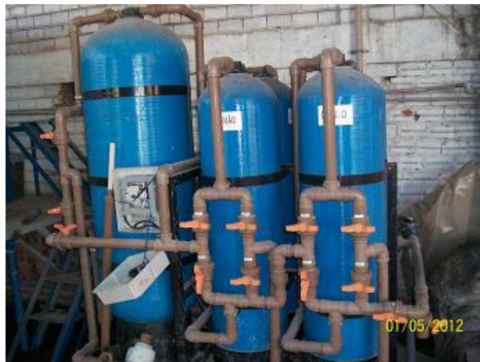
Figura 24 – Filtros de areia (à esquerda) e carvão ativado (à direita) para polimento do efluente tratado por eletrocoagulação.
