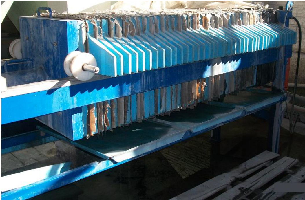
Figura 21 – Filtro-prensa utilizado para remover umidade do lodo formado na eletrocoagulação.
