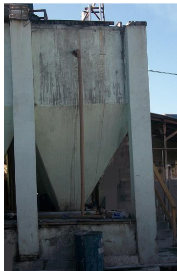
Figura 20 – Decantador existente na estação de tratamento de efluentes do curtume.
