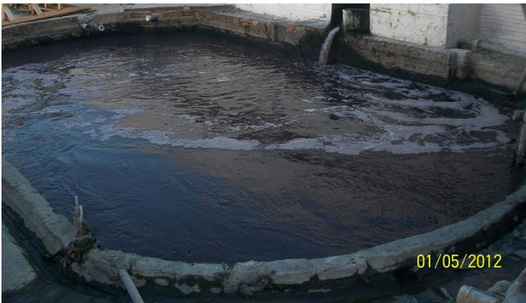
Figura 7 – Tanque de Equalização / Homogeneização.
