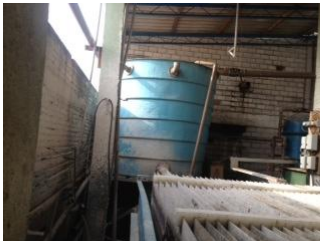
Figura 23 – Tanque de acúmulo de efluente clarificado.
