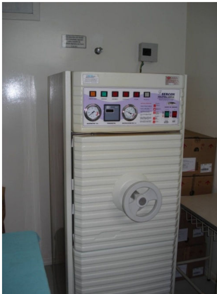
Imagem 30: Sala de esterilização
