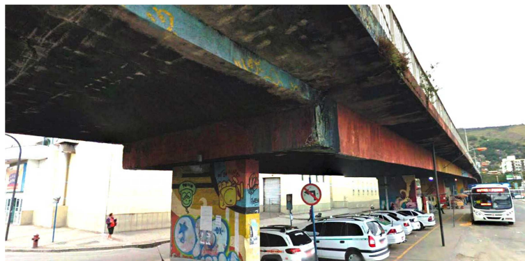
Figura 18: Ocupação de viaduto.
