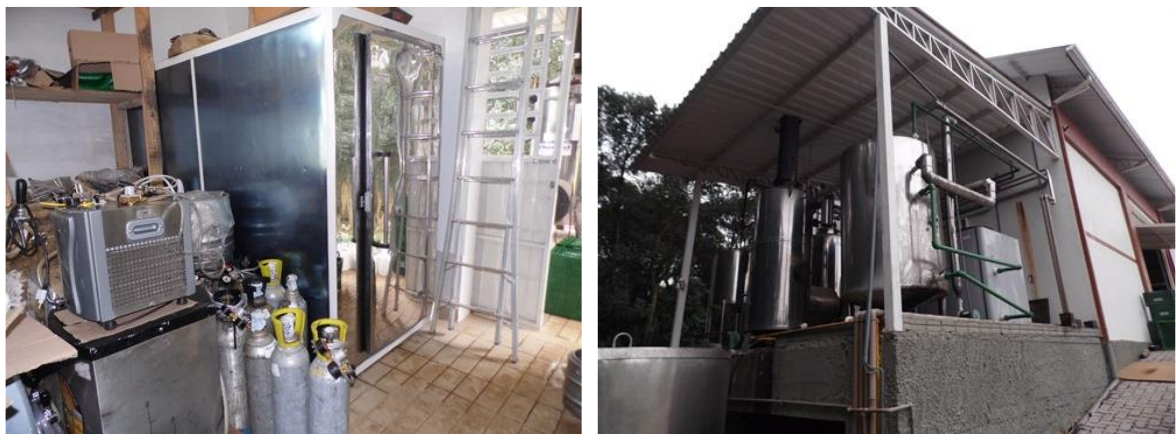
Figura 22 – Câmara fria e reservatórios (álcool, água quente, água fria e caldeira)
