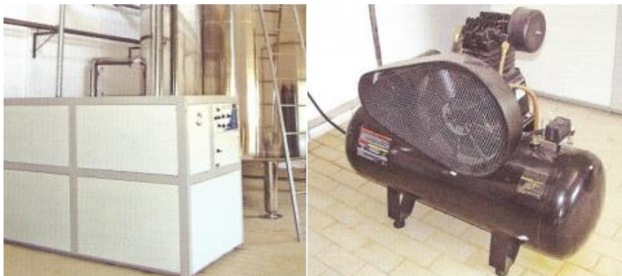
Figura 15 - Gerador de água gelada e compressor de ar
