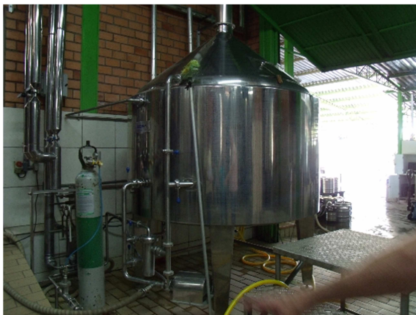
Figura 23 - Tanque de resfriamento.
