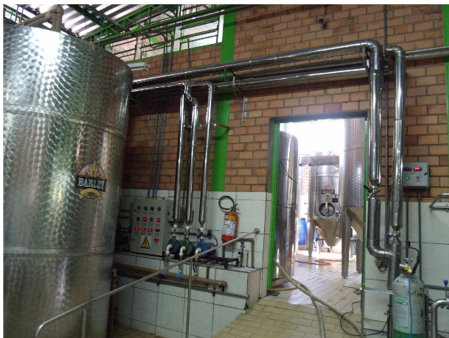
Figura 25 - Tanques com os painéis eletrônicos para controle.
