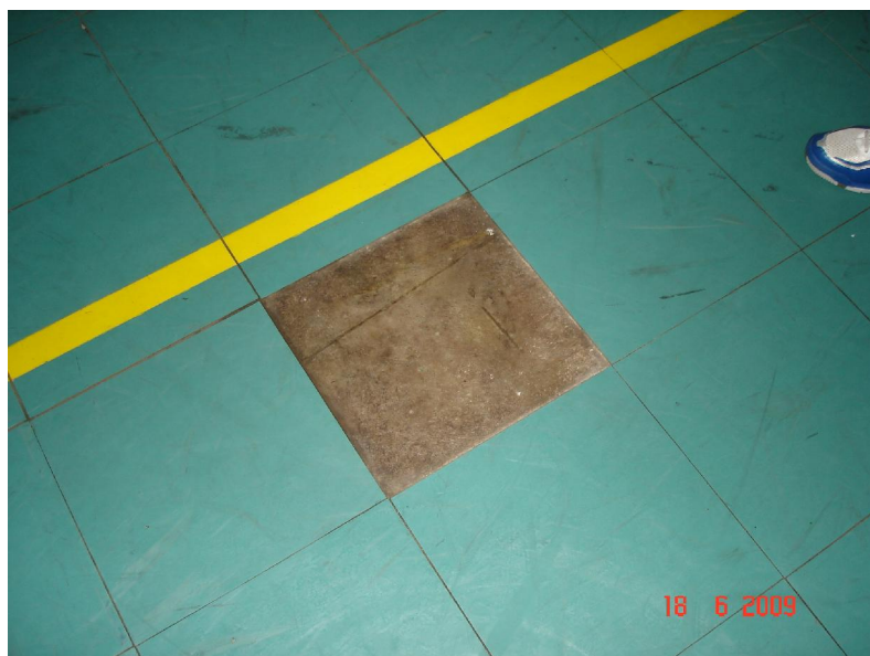
IMAGEM 24 – Piso descolando. Fonte: AUTOR, 2009.
