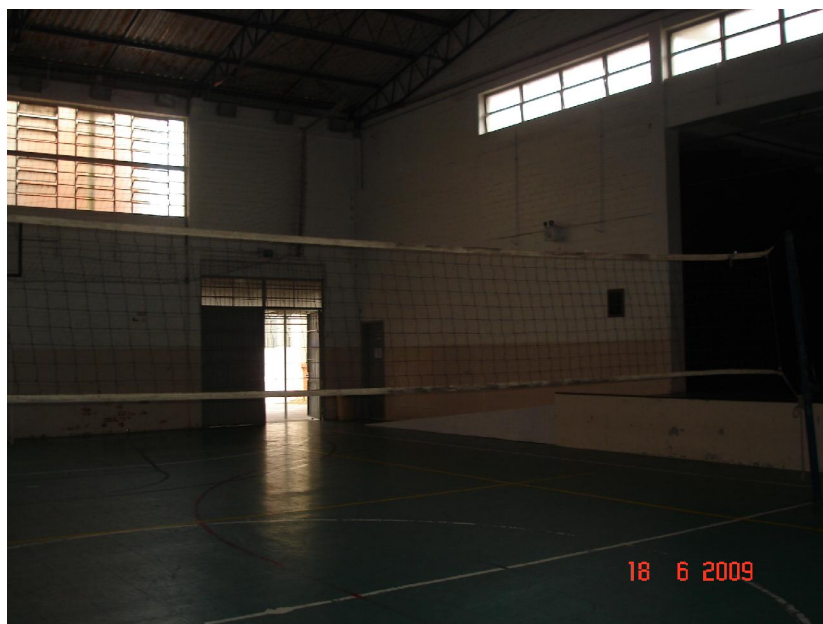
IMAGEM 25 – Equipamentos precários. Fonte: AUTOR, 2009.
