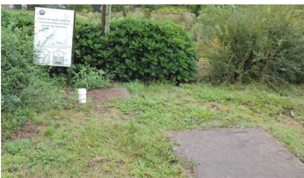
Figura 37 – Tratamento de esgoto
