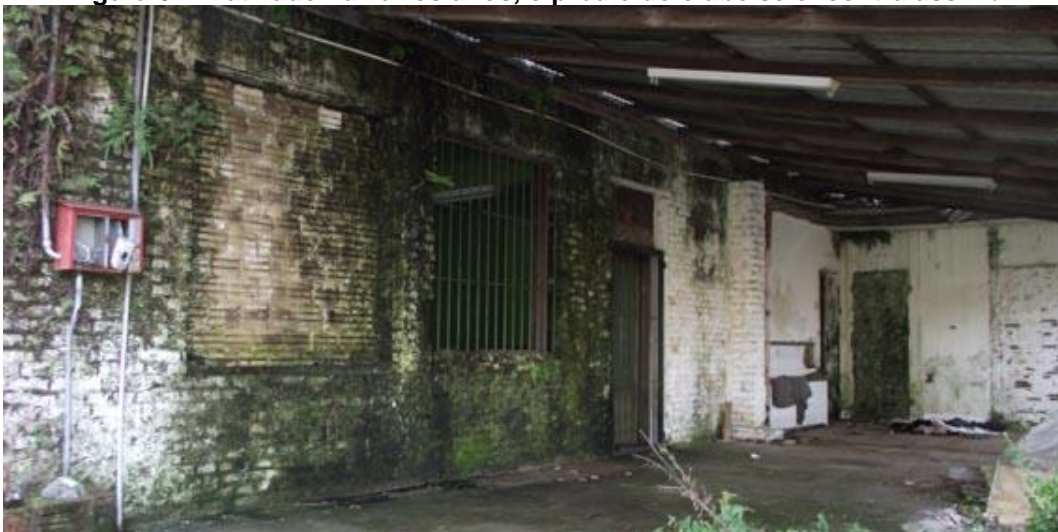
Figura 6 – Inativado há vários anos, o prédio do clube se encontra assim.
