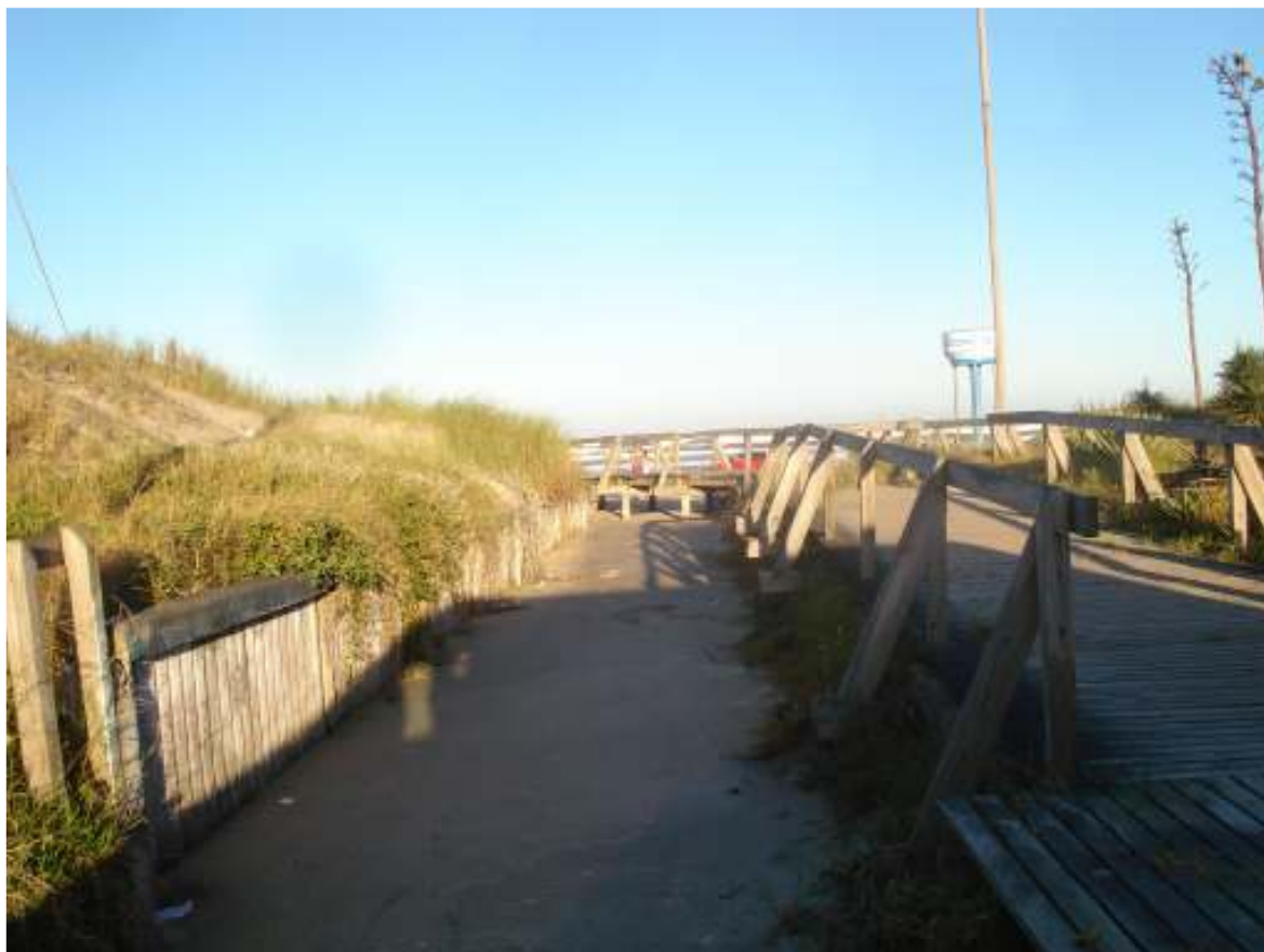
Imagem 95: Forma atual de contenção das dunas com placas de concreto Fonte: Thaís Luft da Silva, 2009.
