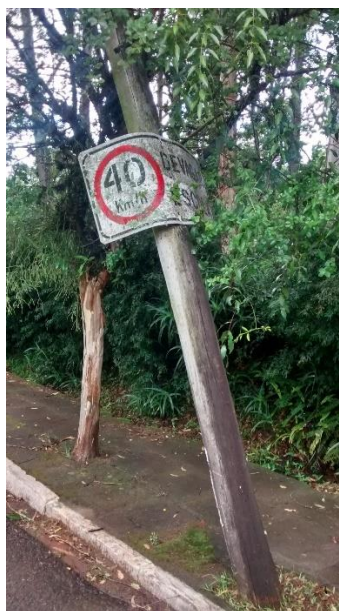
Figura 30 – Poste de energia elétrica
