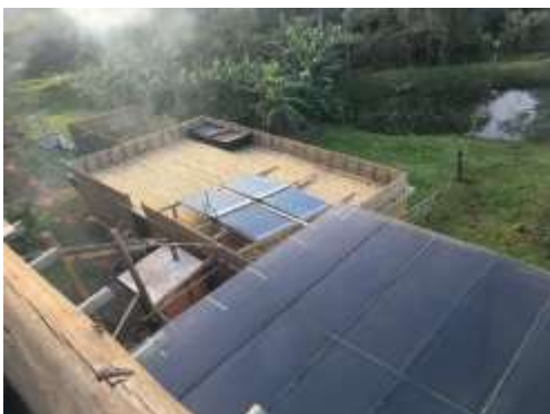
Figura 53 –Aquecimento da piscina
