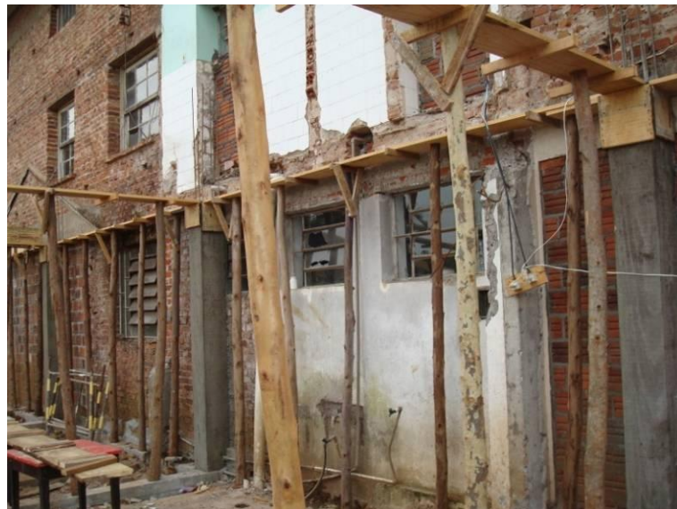
Figura 10 - Fachada Oeste, fundos, da Sociedade Santa Cecília, que permanece sem reboco. Fator que causa muita vergonha aos moradores da cidade, pois tem vista da nova Rodovia RS 122 Fonte: Autora, 2009
