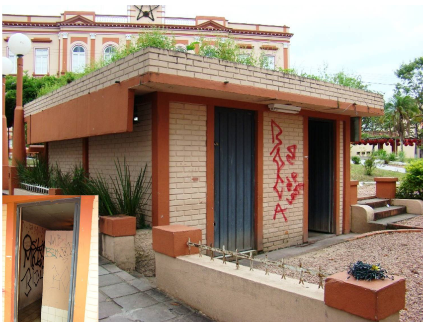
Imagem 07 - Sanitários da Praça Marechal Deodoro, em mau estado de conservação e mal cheirosos. O detalhe mostra pichações no interior de um deles.
