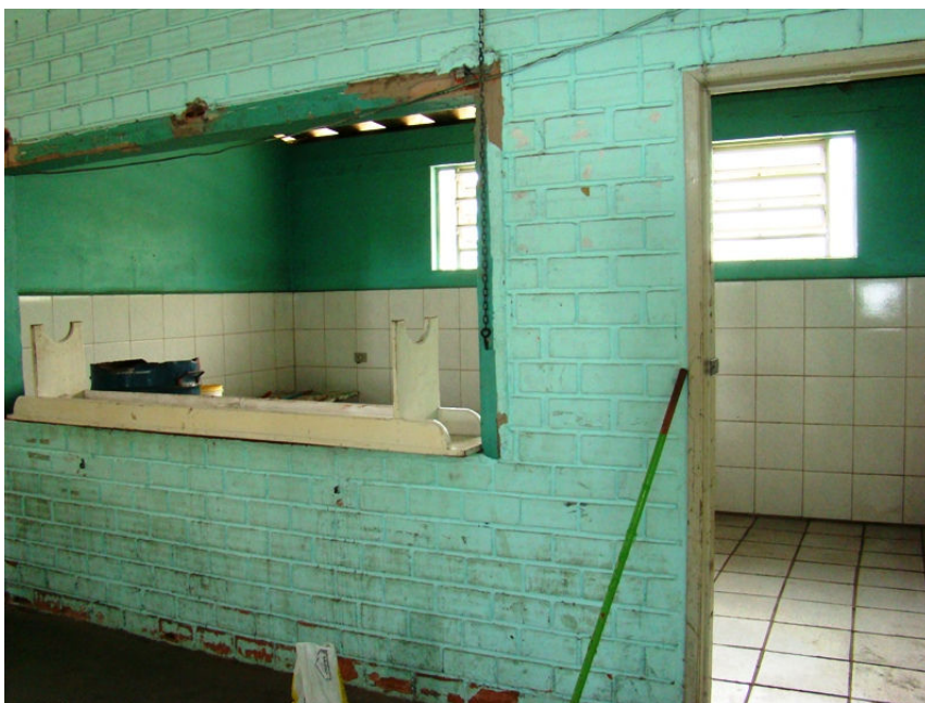
Imagem 31 - Vista interna do Ginásio Municipal localizado no Parque do Trabalhador de Taquara: cozinha, em péssimas condições de uso.
