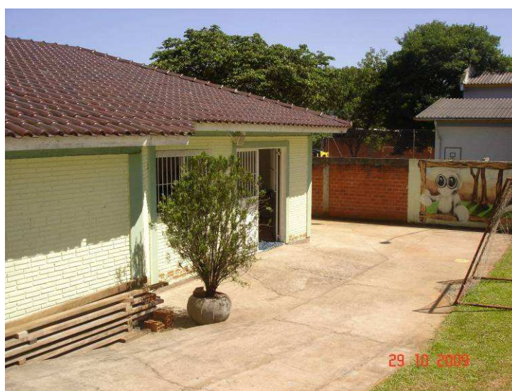
Imagem 02: Entrada do refeitório, calçada sem cobertura
