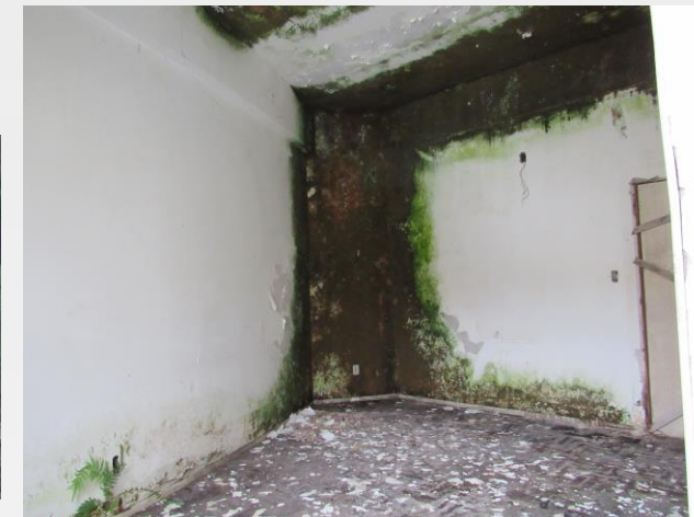
Fig. 81: Sala com mofo (ARQUIVO PESSOAL, 2019).
