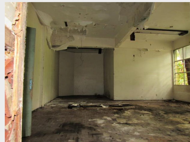
Fig. 80: Sala com descascamento do forro (ARQUIVO PESSOAL, 2019).
