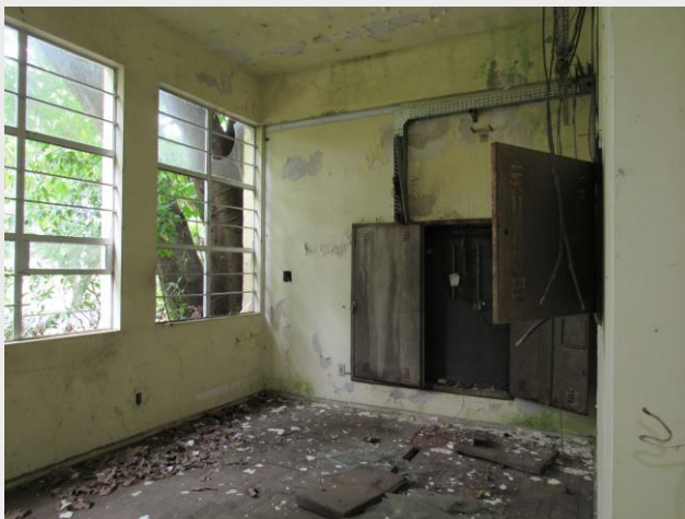
Fig. 78: Sala com central de elétrica (ARQUIVO PESSOAL, 2019).
