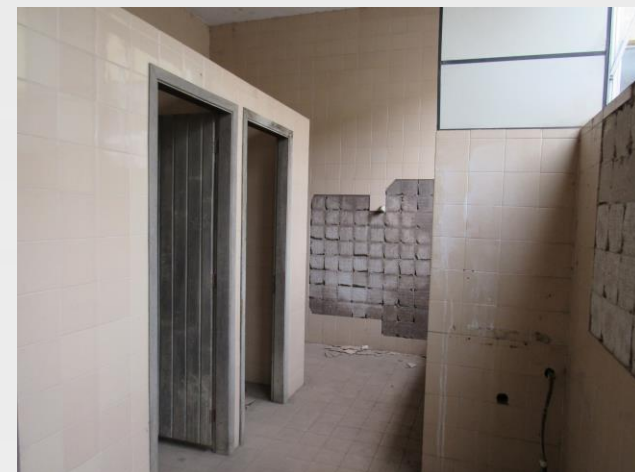
Fig. 85: Desplacamento de azulejos (ARQUIVO PESSOAL, 2019).
