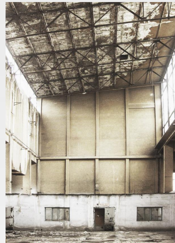
Fig. 09, Estado de degradação do interior da edificação (EMRE AROLAT ARCHITECTS, 2019).
