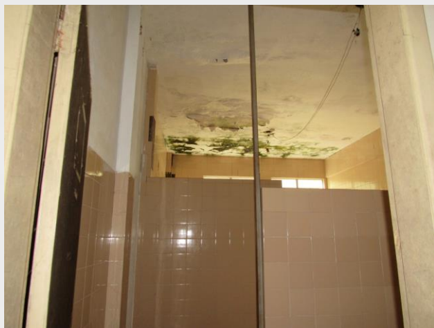
Fig. 83: Banheiro, teto com mofo (ARQUIVO PESSOAL, 2019).
