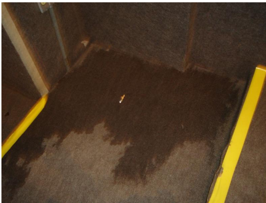
Figura 27 - Infiltração no piso da Casa de Pedra
