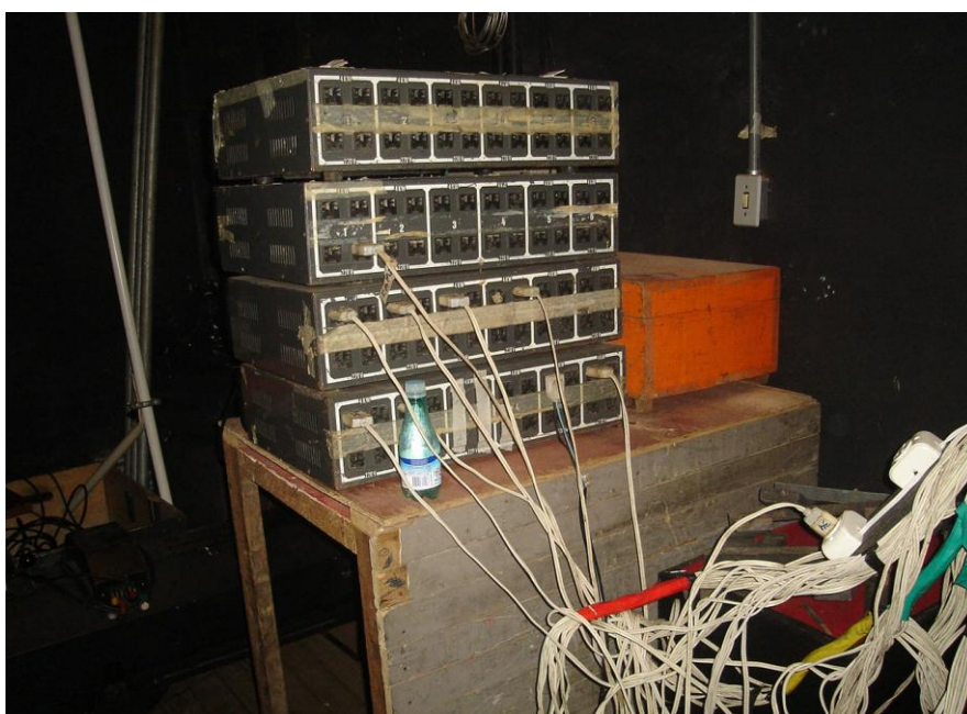
Figura 28 - Imagem do sistema elétrico do teatro casa de pedra
