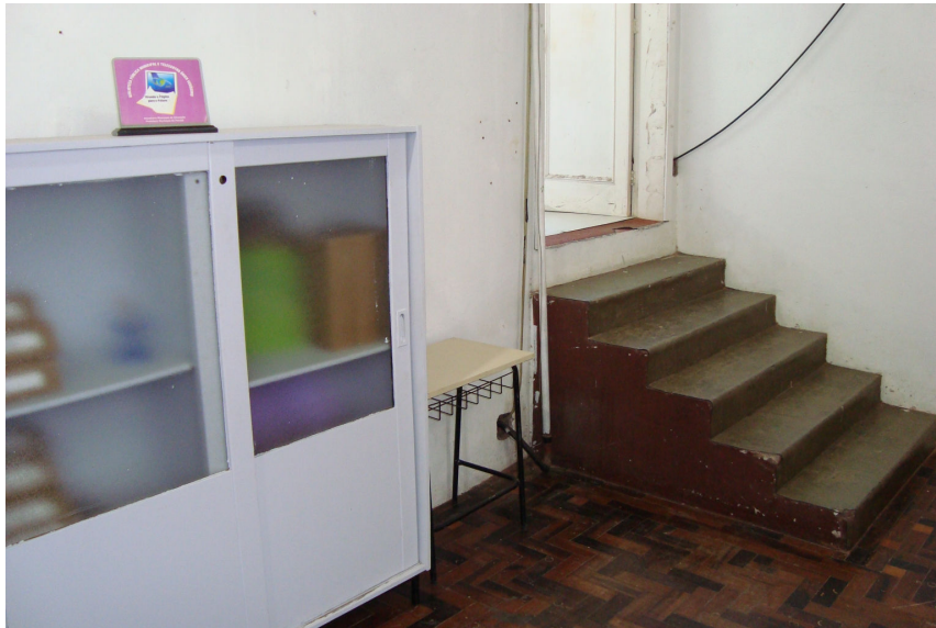
Figura 2.5 – Falta de acessibilidade à sala de estudos
