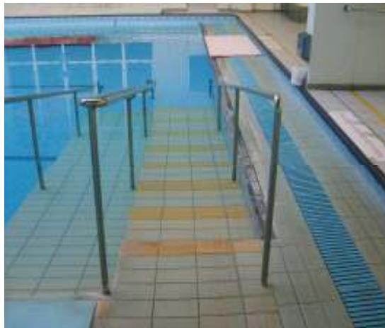
Imagem 37: Rampa com piso antiderrapante (KLEIN, 2008).
