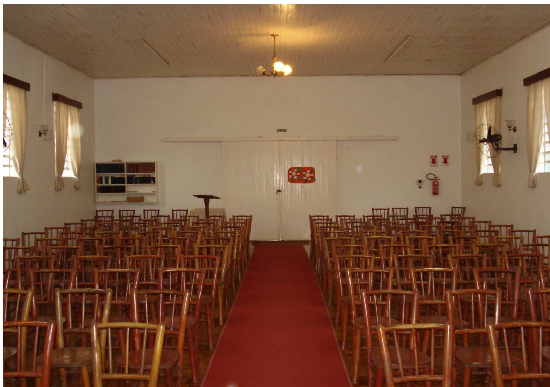
Imagem 44: Nave da Igreja com patologias no forro de madeira. Fonte: Autor (2010).
