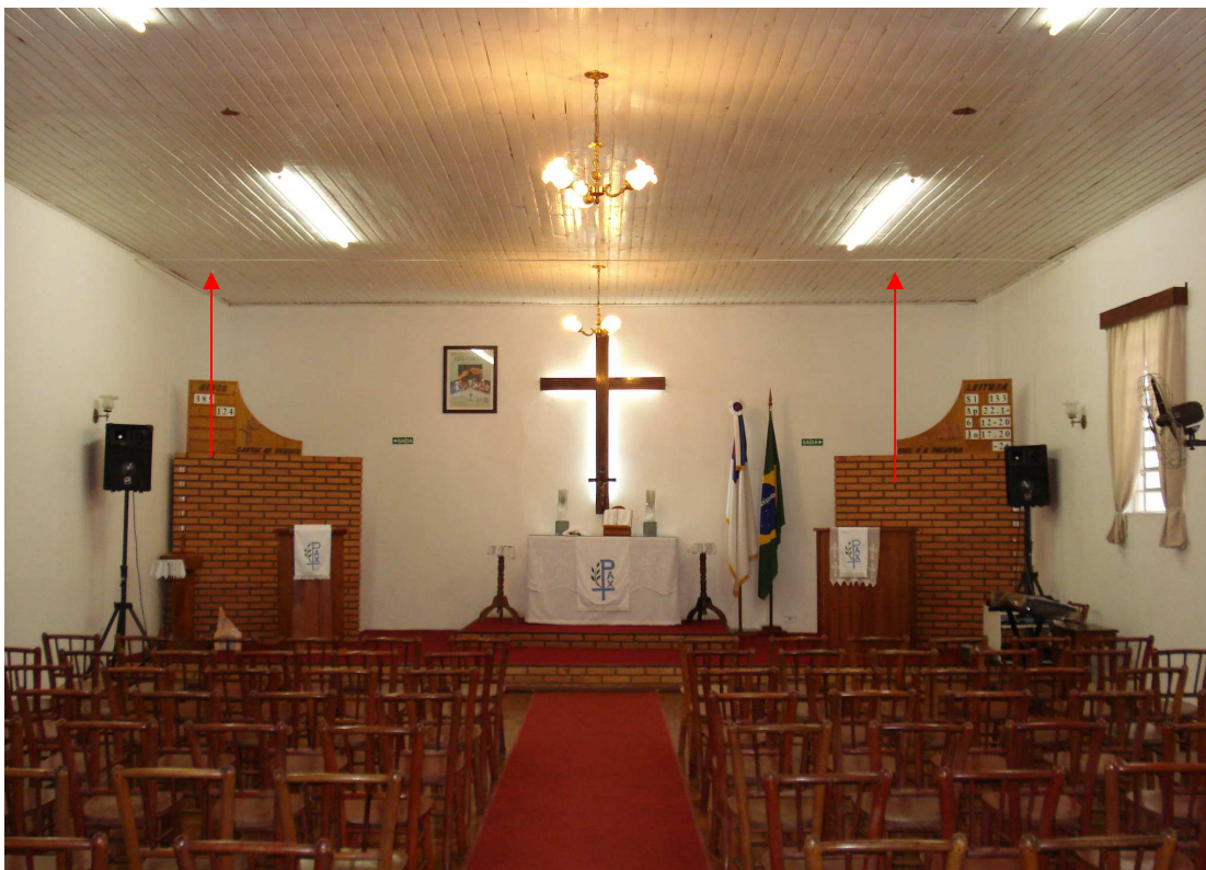
Imagem 45: Um cabo de aço (tirante) reforçando a estrutura das paredes laterais. Fonte: Autor (2010).
