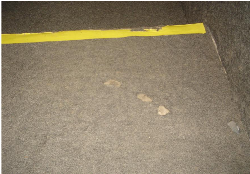
Figura 29 - Piso em má conservação e sinalização com fita
