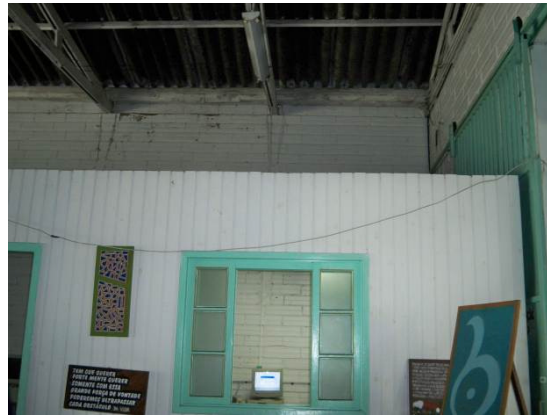
Imagens 3.22 - Estrutura do galpão – instalações elétricas precárias (AUTORA, 2010).
