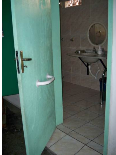
Imagem 3.10 - Puxador lado interno da porta no banheiro (AUTORA, 2010).
