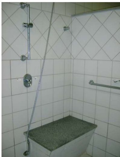
Imagem 3.29 - Chuveiro adaptado com banco e barras de apoio (KLEIN, 2008).
