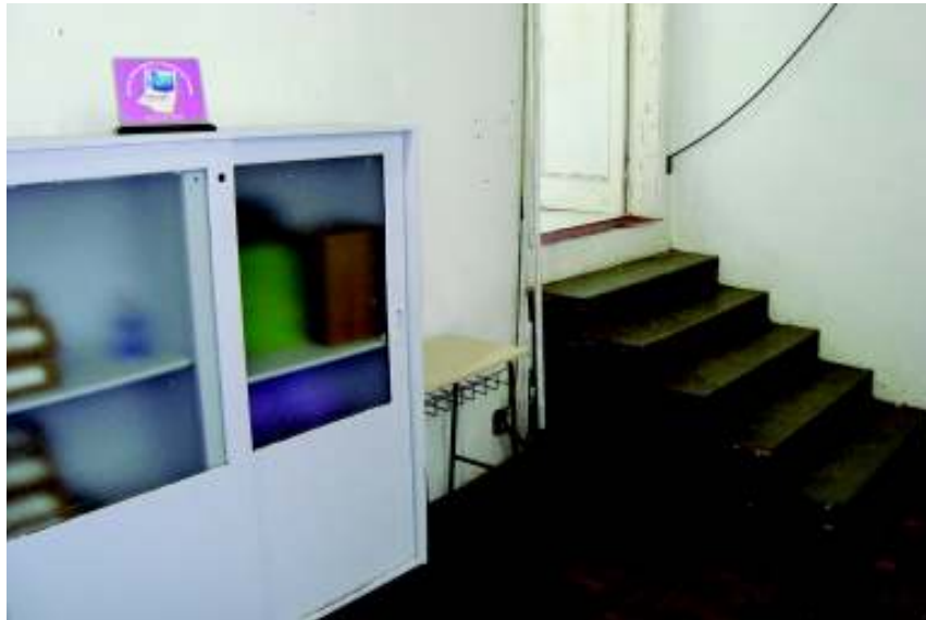
Figura 2.5 – Falta de acessibilidade à sala de estudos
