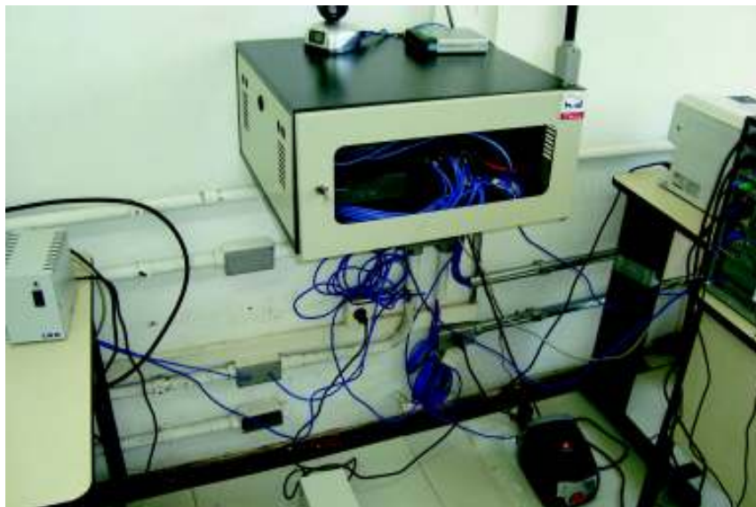
Figura 2.6 – Precariedade na instalação de hardwares
