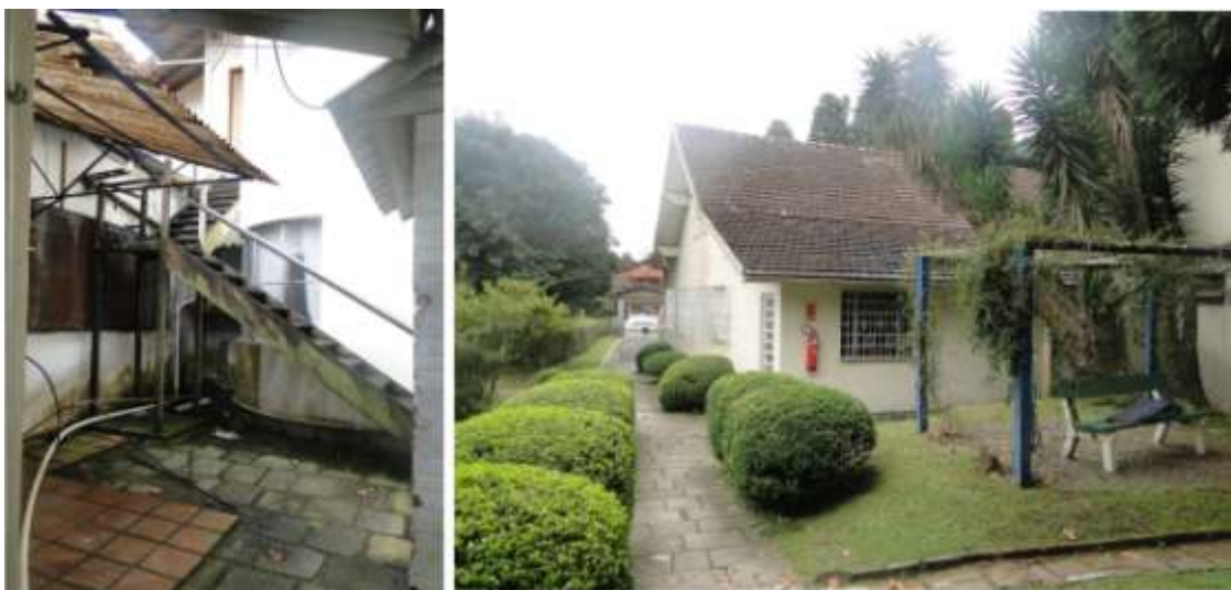
Imagem 72: Construção anexa ao prédio central do antigo hotel em condições ruins
