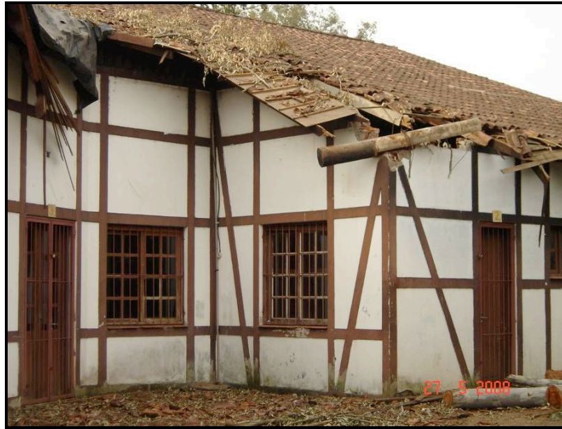
Figura 19 - Antigo restaurante danificado
