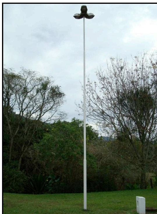
Figura 27 - Luminária metálica alta
