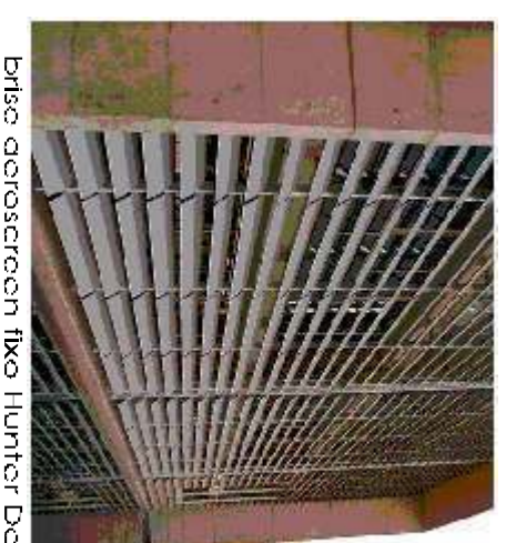
depois da construção do novo sistema de arrefecimento
