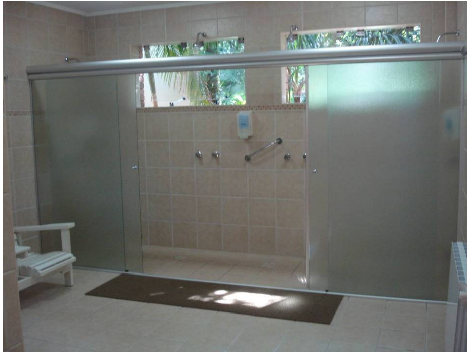
Imagem 93 – Chuveiros do vestiário masculino de apoio a piscina.
