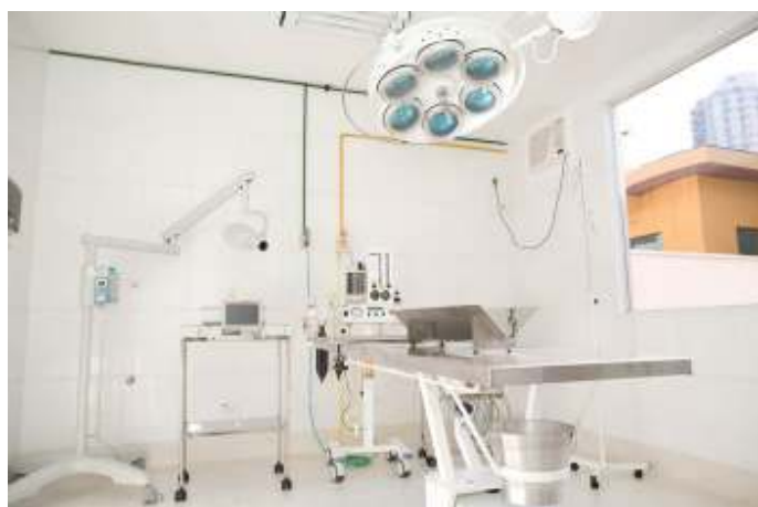
Figura 6 Centro cirúrgico veterinário Fonte: CESUMAR (2012)
