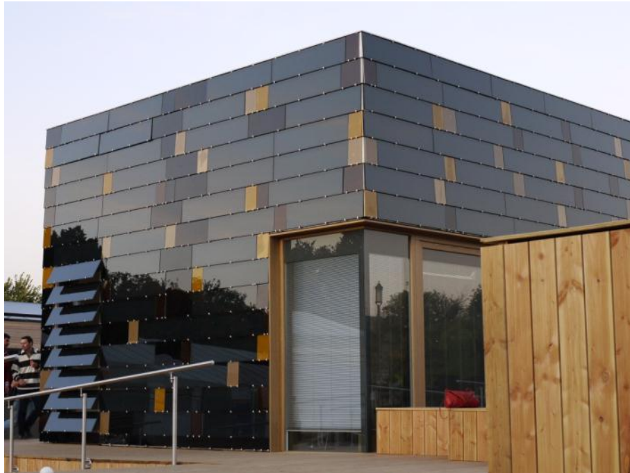
Figura 67 - Painéis fotovoltaicos na fachada
