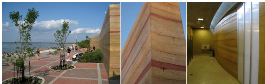
Figura 54 - Uso da parede de taipa em áreas com bastante umidade. Grand Beach Washrooms, Manitoba. MPP Architects
