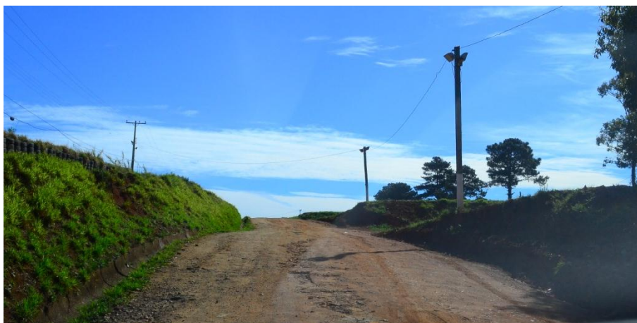
Figura 17 – Acesso ao estacionamento sem pavimentação
