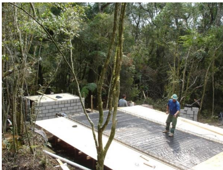
Imagem 46- Blocos de concreto armado - define o porão, eleva e sustenta a laje de concreto
