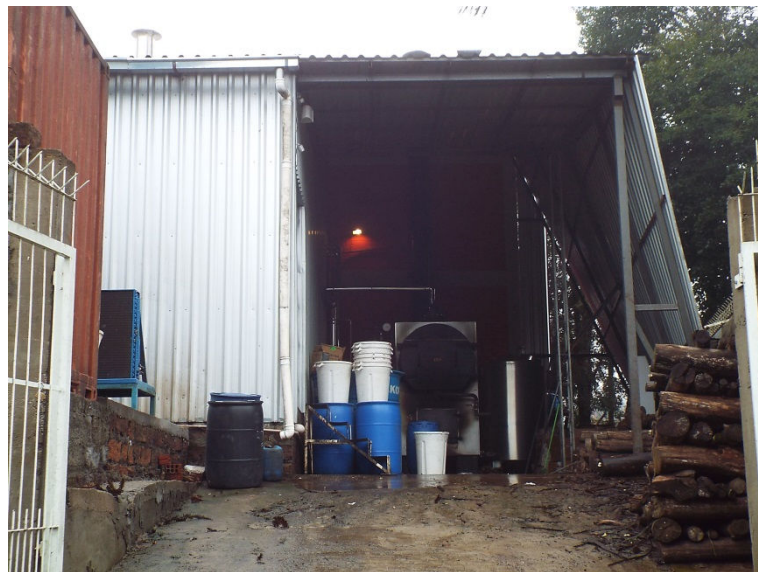
Figura 23 – Tanques de aquecimento e resfriamento da água
