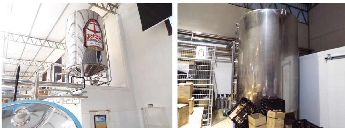
Figura 34 – Reservatórios de água quente e fria
