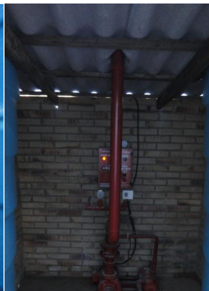
Figura 19 - Casa de bombas do sistema
